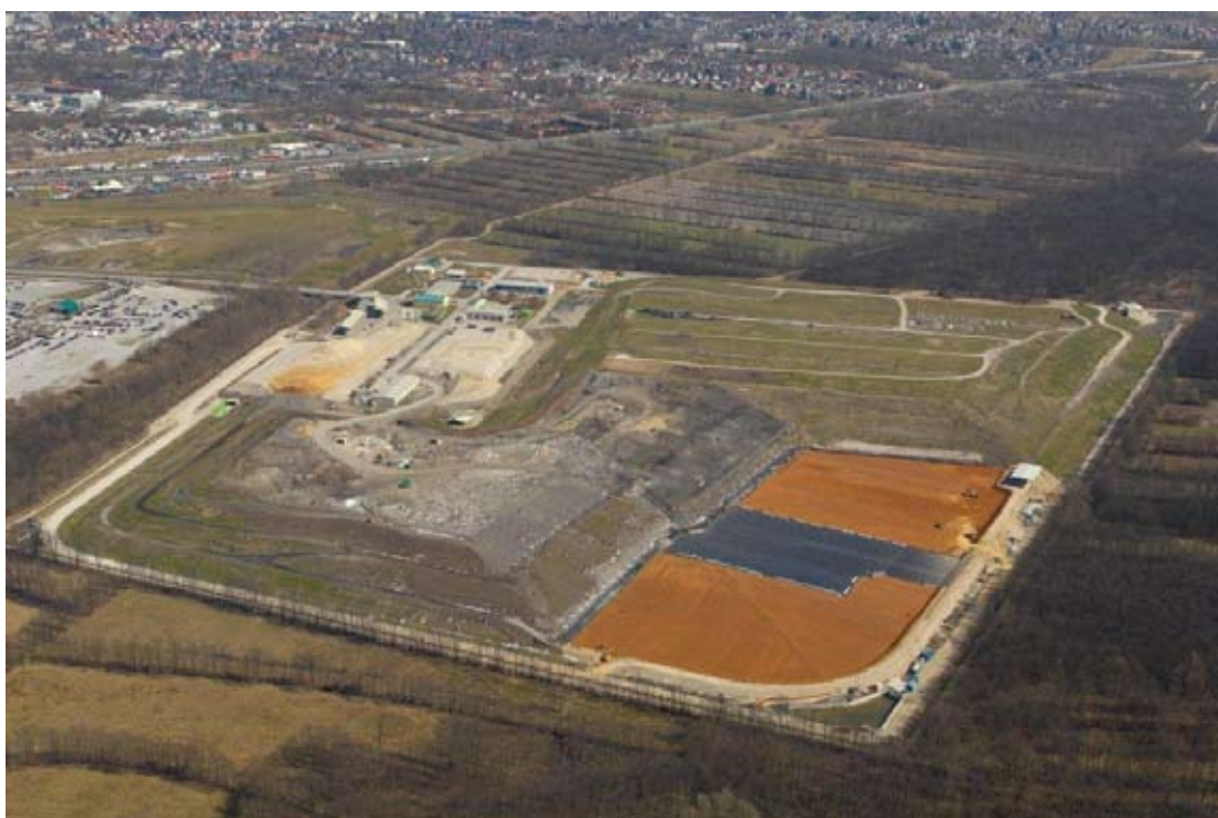
Območje odlagališča odpadkov Barje v Ljubljani – spodaj desno je vidno področje gradbišča 3. faze odlagalnega polja s tesnilnimi sloji iz gline in deloma že s PEHD folijo, levo zgoraj pa peščeni predobremenilni nasipi, s katerimi se izboljšuje nosilnost temeljnih tal na področju bodočih objektov za predelavo odpadkov ter čistilne naprave za izcedne vode (foto arhiv Snaga d.o.o.)
