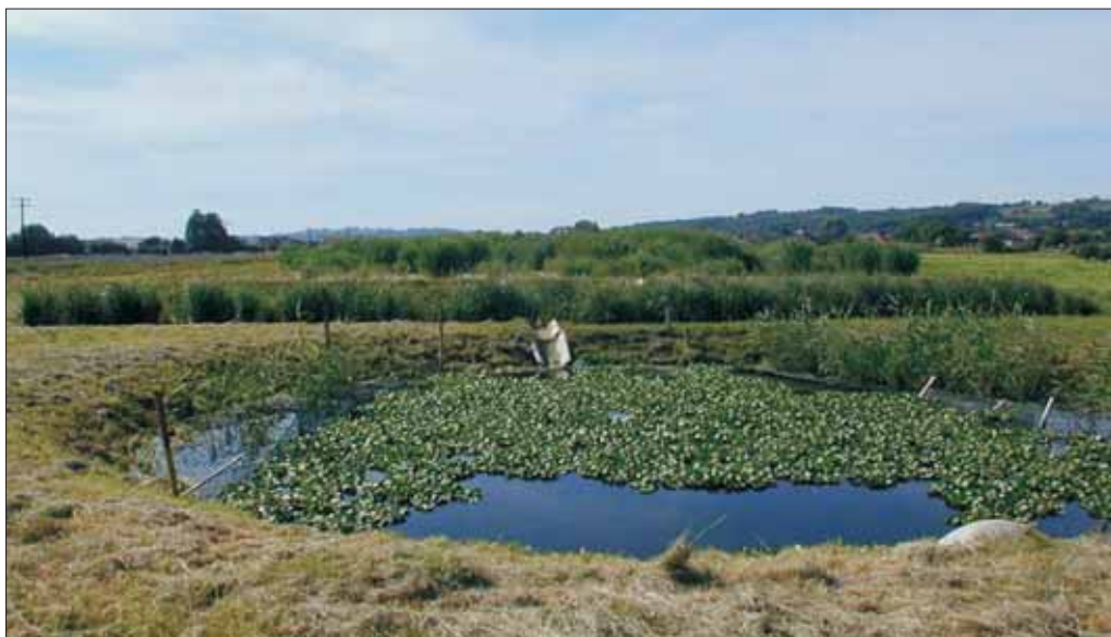
Slika 28: Rastlinska čistilna naprava za čiščenje komunalnih odpadnih voda iz naselja Velika Nedelja (Vir: Arhiv podjetja LIMNOS)
