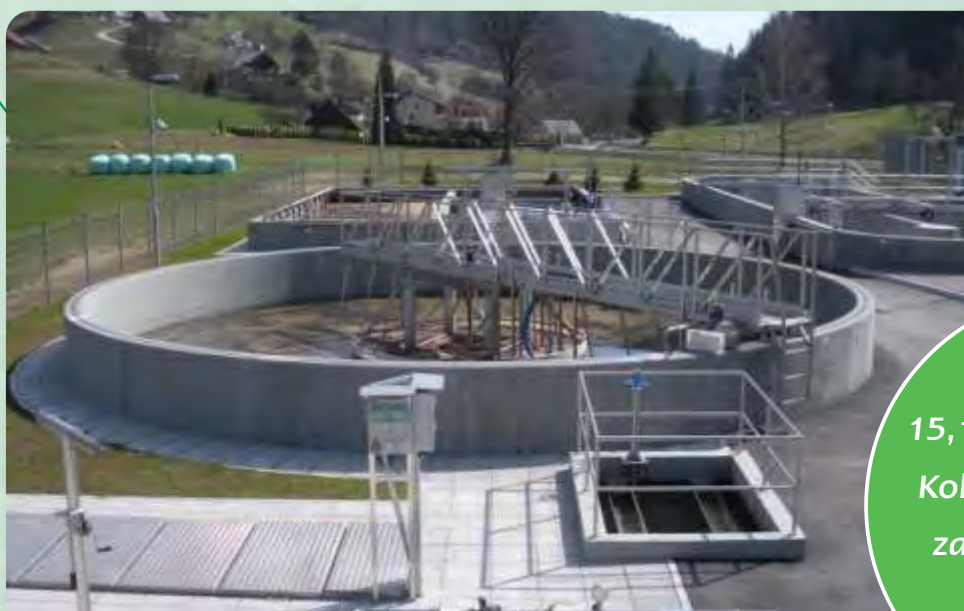
čistilna naprava Dobrna
